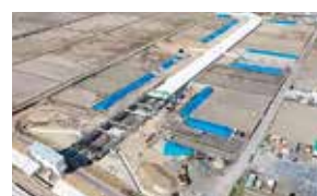
放水路の整備状況
