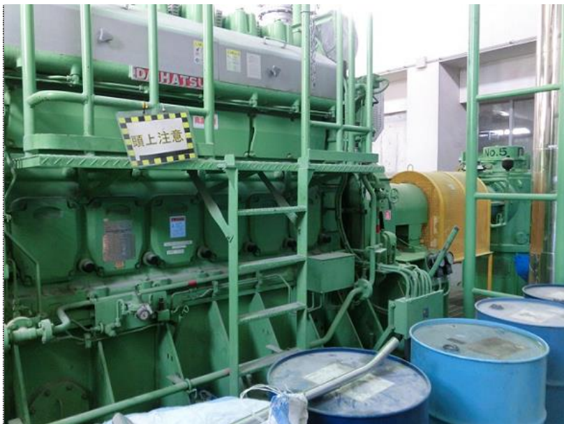
No.5原動機 ディーゼル機関 * No.6と同等機関
