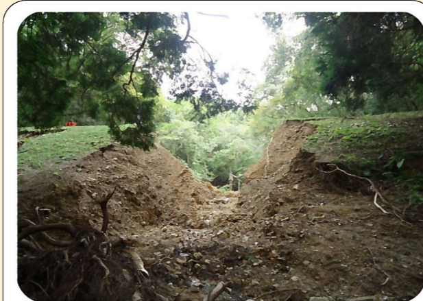
平成25年9月、大雨により決壊した他市町村のため池
