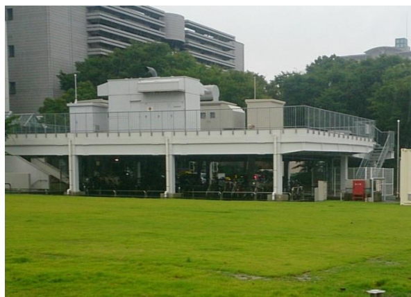
非常用電源設備下部の駐輪場 (128 台)
