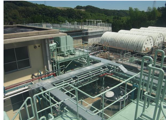
汚水処理施設
