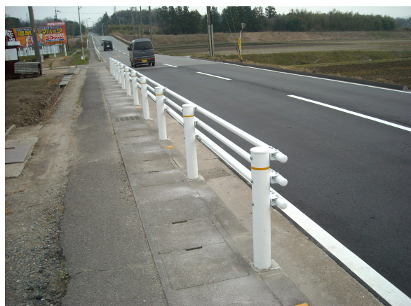
ガードパイプ
