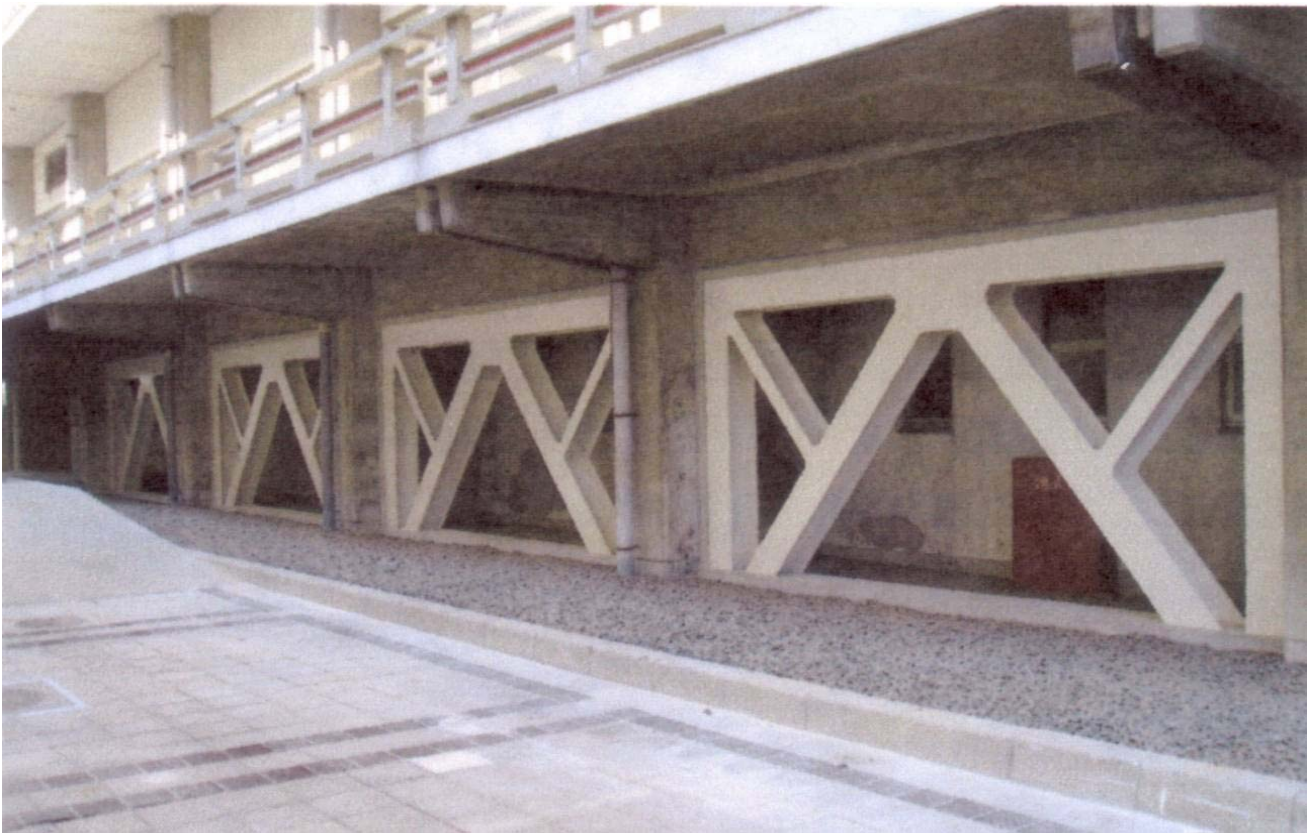
外部耐震ブレース
