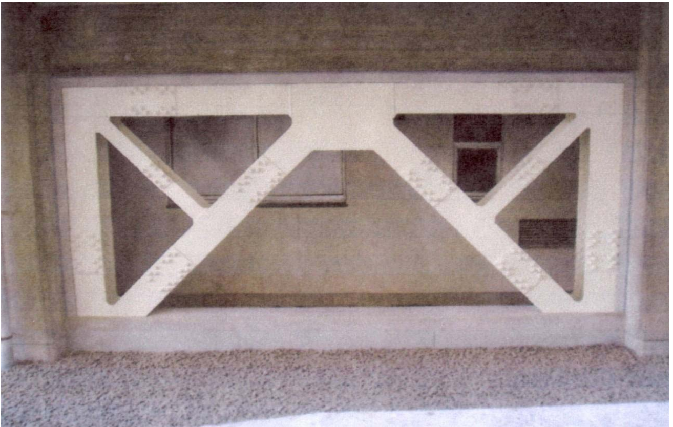
外部耐震ブレース
