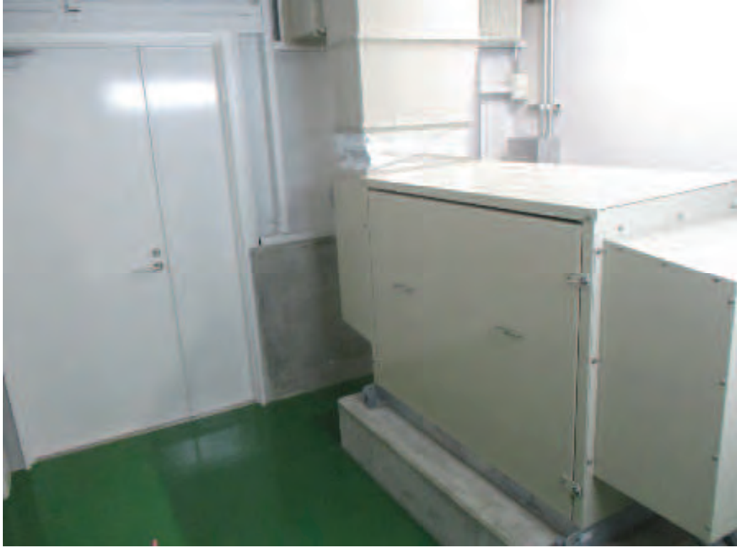
内観(発電機室)
