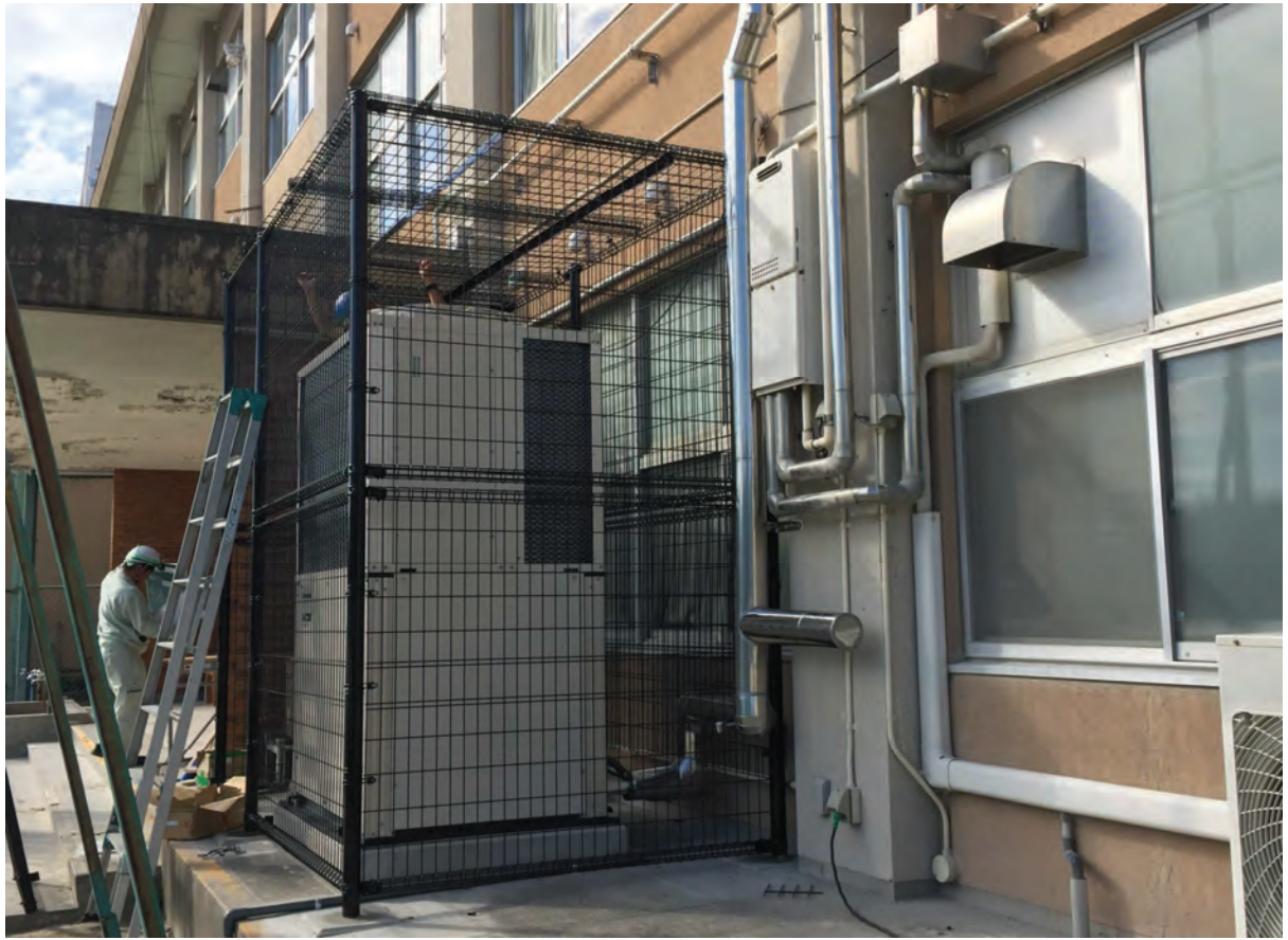
室外機フェンス
