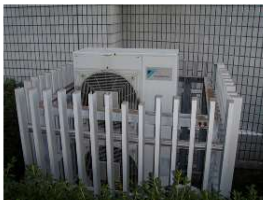
展示棟空調機（室外機）外観
