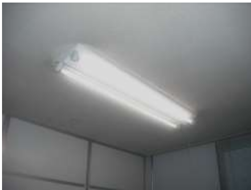
既設照明器具 (蛍光灯 消費電力 90W 程度)
