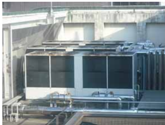
図2.チラーユニット
