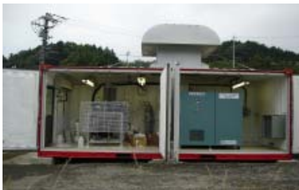
鈴鹿山麓リサーチパーク内で実証試験中の燃料電池
