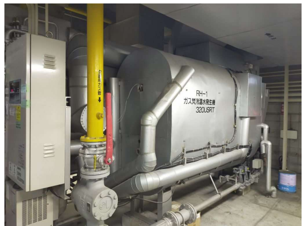
冷温水発生機
