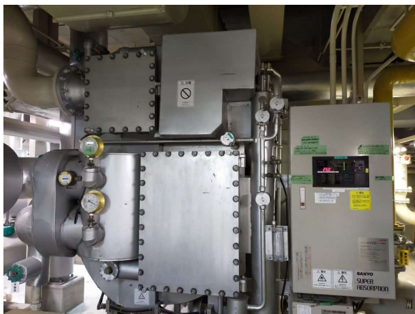
冷温水発生機
