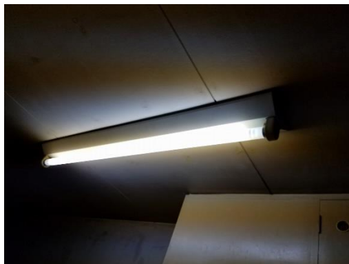
既設照明器具（蛍光灯）
