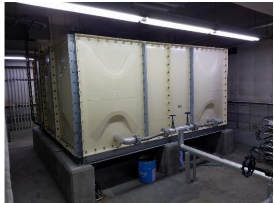
市庁舎北館機械設備更新工事(受水槽)
