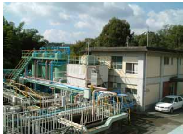
汚水処理施設
